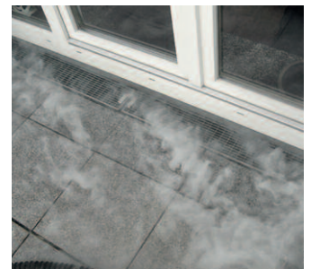
Gebrekkige afdichting van een dakterras.
