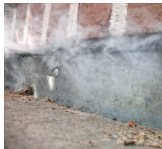
Bewijs voor een beschadigde afdichting bij de wandaansluitingen boven een ondergrondse parkeergarage.
